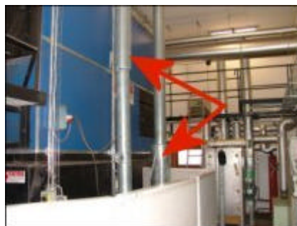
På bilden kan man se dom två fläkt rör som återvinner den varma luften som bildas i tak nivå ovanför pannan.
