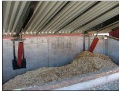
Bredvid panncentralen finns det stora flisförrådet placerat. Förrådet fylls ca 2 gånger i veckan.
