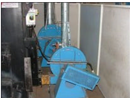
Styrningen på sekundär och primär luften.
