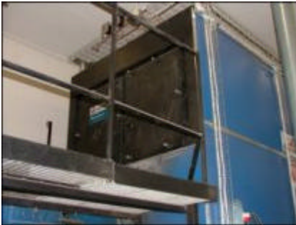
I toppen av pannan finns ett 100-tal tuber som håller effekten hög på pannan.
